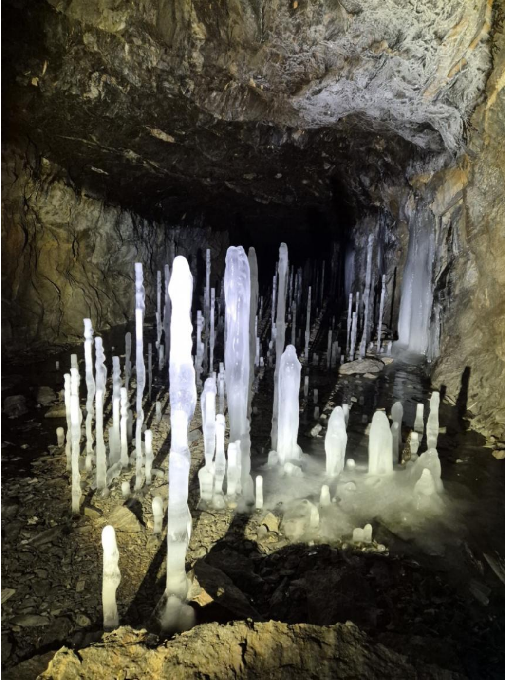
Figur 2: Frosset innlekkasjevann i Polarbanetunnelen. Foto: Ole Hartvik Skogstad.
