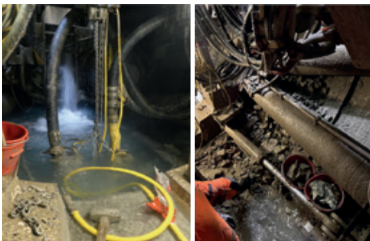
Figur 5. Den mest krevende sonen i råvannstunnelen, med mye innlekkasje og tett oppknust berg.
