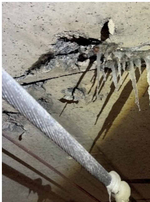
Figur 3: Skade etter kortslutning. Is dannes ved skjøt mellom betongelementer samt på AL-line (som bærer tegn på nedbrytning fra basisk vann).
