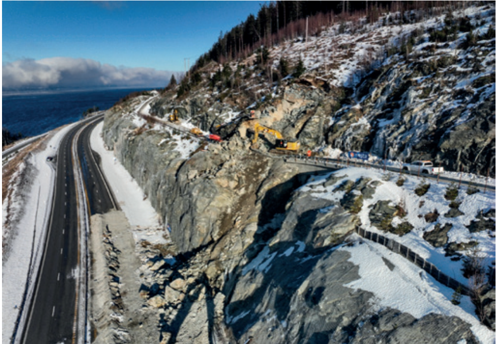
Figur 3. Oversiktsbilde av raset ved E6 Morskogen februar 2025. Foto; Bjørn Frode Johansen, Statens vegvesen.
