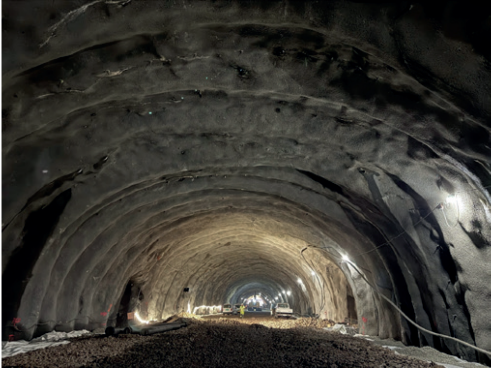
Figur 18 Tetteresultater observert i tunnel sett mot øst.
