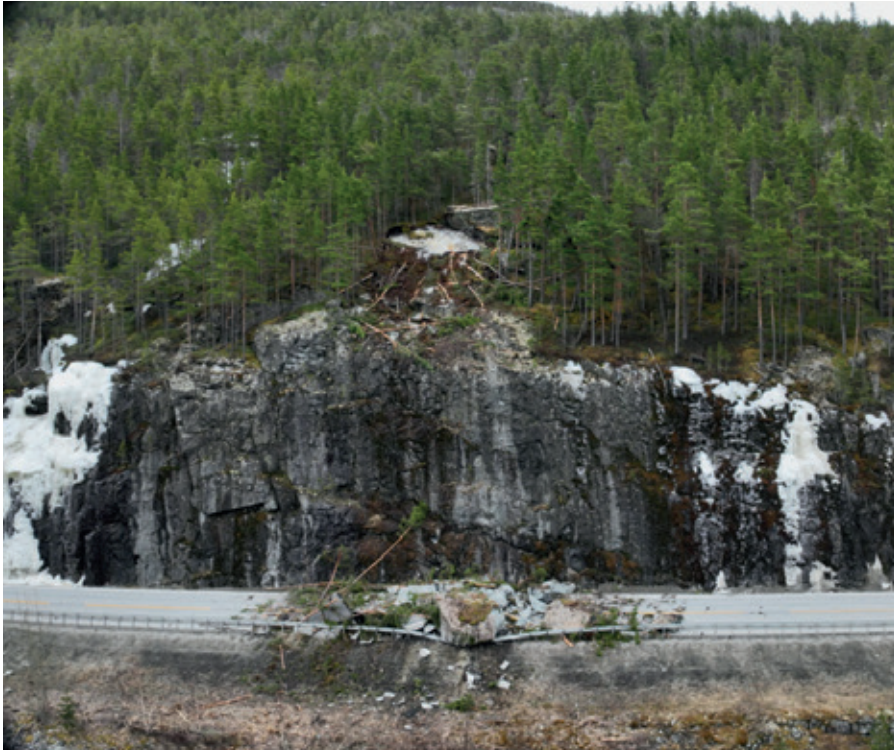
Figur 4; Oversiktsbilde av raset ved E6 Rosten mars 2025. Foto; Statens vegvesen
