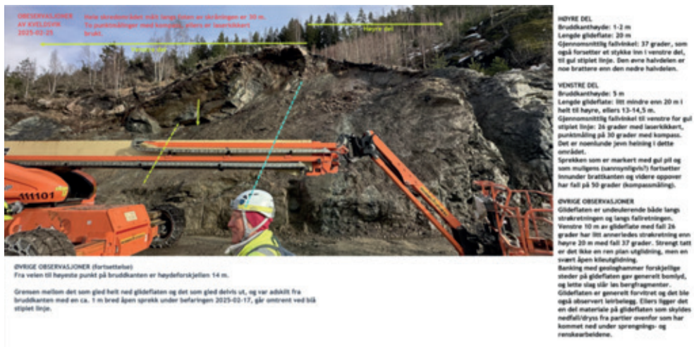
Figur 9. Skredområdet etter nedstrossing og rensk opp til bruddkanten. Foto og befaringsobservasjoner av V Kveldsvik 25.2.2025
