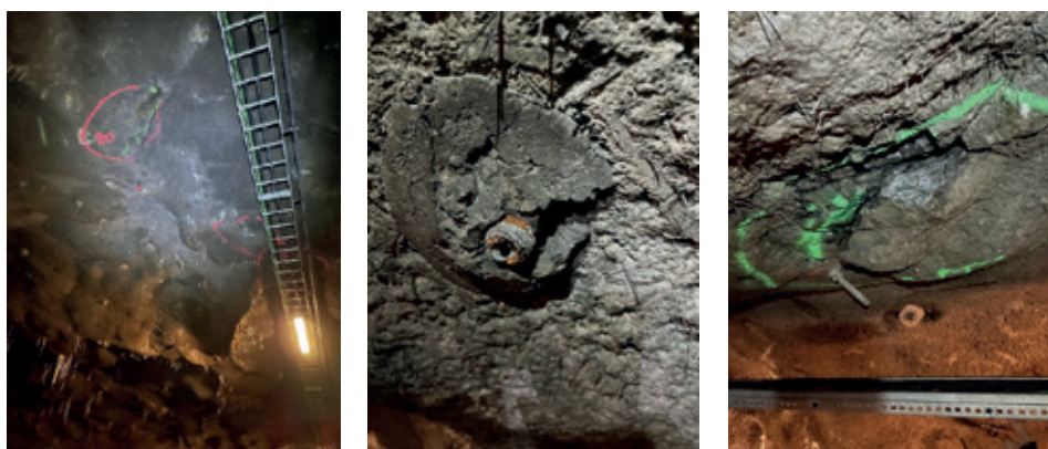
Figur 6 Områder med bom markert. Ødelagt bolter og oppsprukken betong
