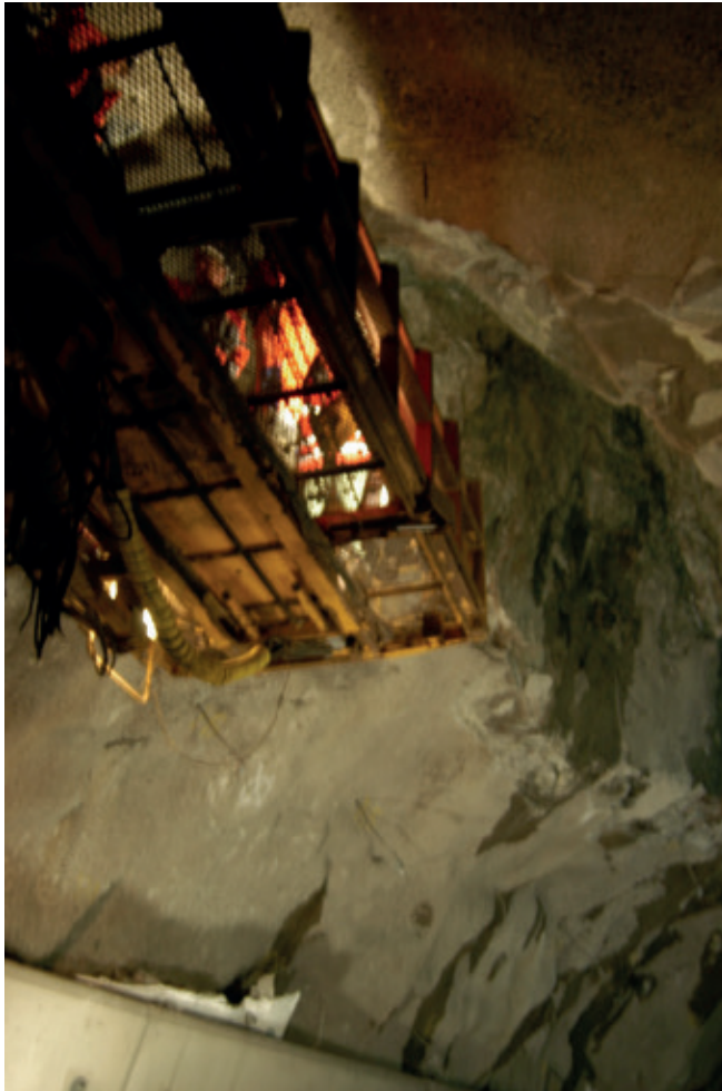
Figur 1. Inspeksjon av raset i Hanekleiva 25. desember 2006. Foto; Kjell Wold, Statens vegvesen
