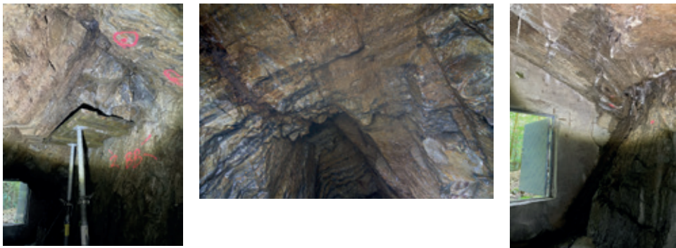
Figur 2 svært avløste kiler, åpne sprekker og rotinntrenging
