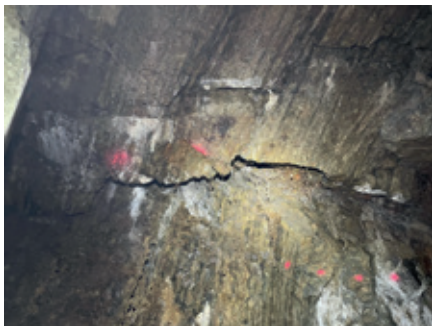
Figur 8 Tunnel fra 1955. Leirskifer og knollekalk. Spesielt knollekalken var svært forvitret. Mye rotinntrengning
