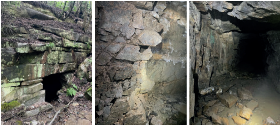
Figur 4 blokkopsprukken portalåpning. Svært forvitret bergmasse, vurdert som dypforvitret. Blokkoppsprekking og nedfall
