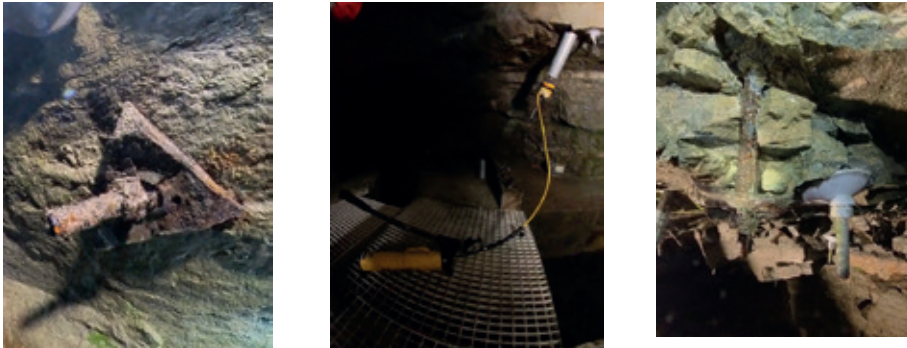
Figur 10 Rusten bolteskive, mutter og gjengeparti, denne bolten ble prøvetrukket til 16 tonn. Utstyr for prøvetrekking av bergsikringsbolt. Erstattet bergsikringsbolt
