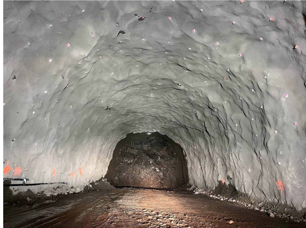
Tørt profil, noe fuktflekker
