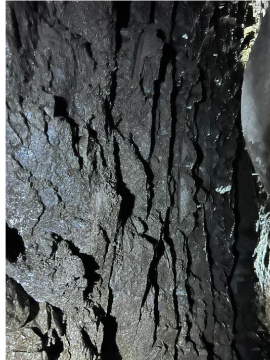
Stuff 03.02. Mye oppsprekking + forvitring. Lav Q-verdi
