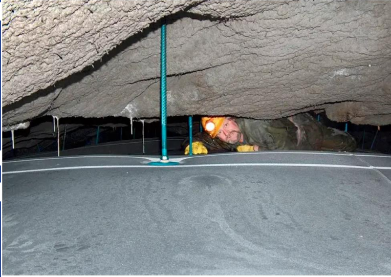
Raset i Hanekleivtunnelen på E18 i Vestfold førte først til stengning og kontroll av seks tunneler på samme veistrekning, senere kom det krav om kontroll av alle tunneler i Norge. Foto: HÅKON MOSVOLD LARSEN/SCANPIX
