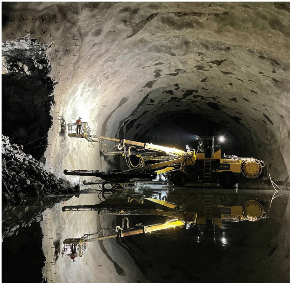
Bilde av en elektrisk borerigg.
