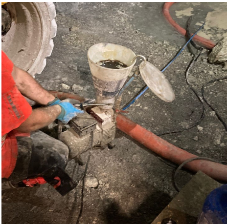
Separat pumpe med kjemisk injeksjon
