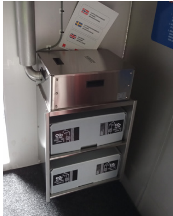
Bilde 5.1. Skrubberanlegg (Foto: Jarle Gausen)
