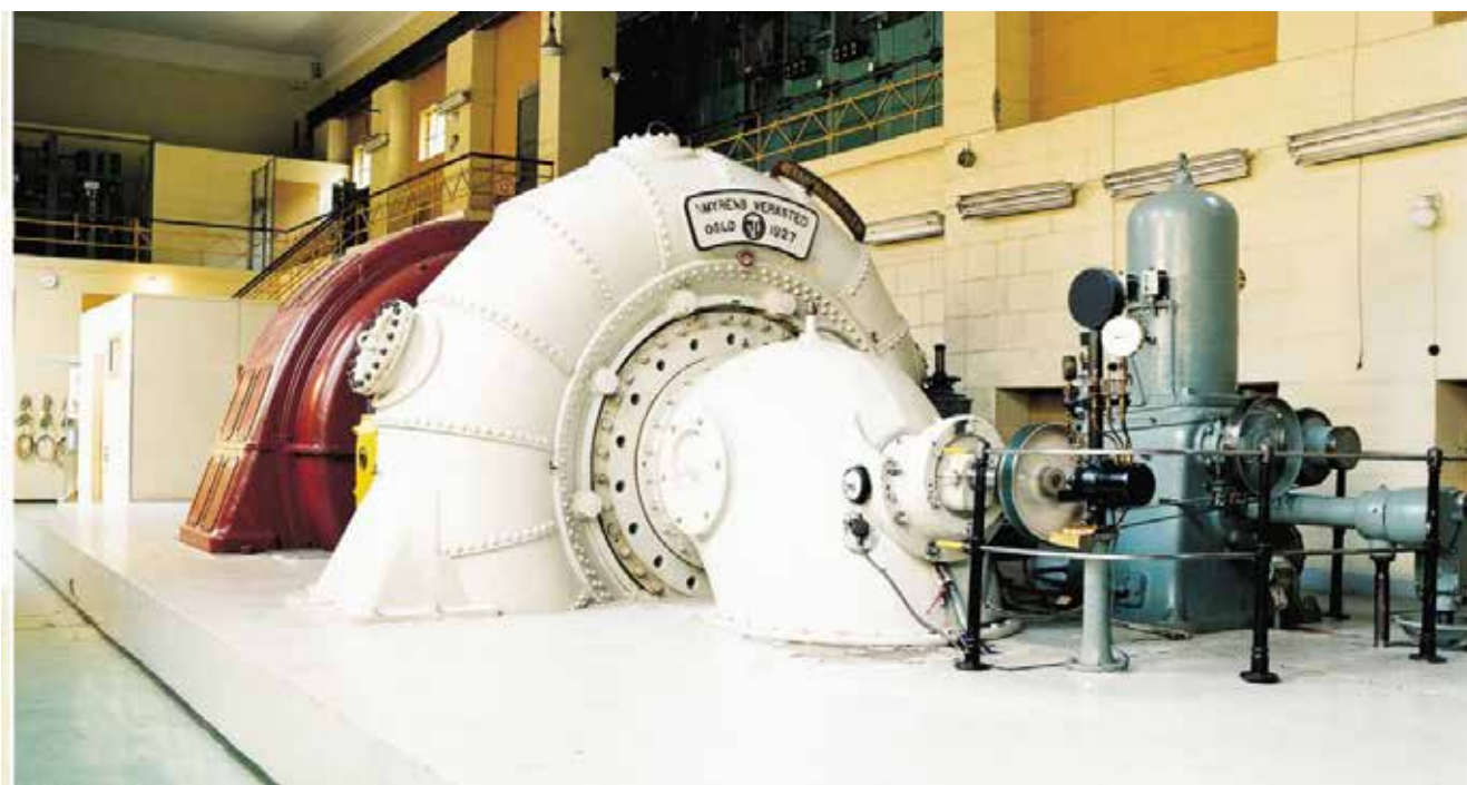
Hammeren kraftverk i Maridalen. Eneste kraftverk i Oslo. I drift fra år 1900. Fortsatt i drift
