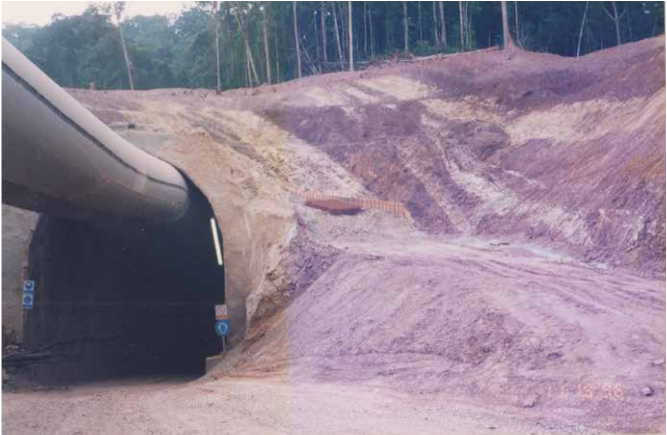
Restaurert påhugg etter at det kollapset under monsunen grunnet undergraving av portalstøpen.
