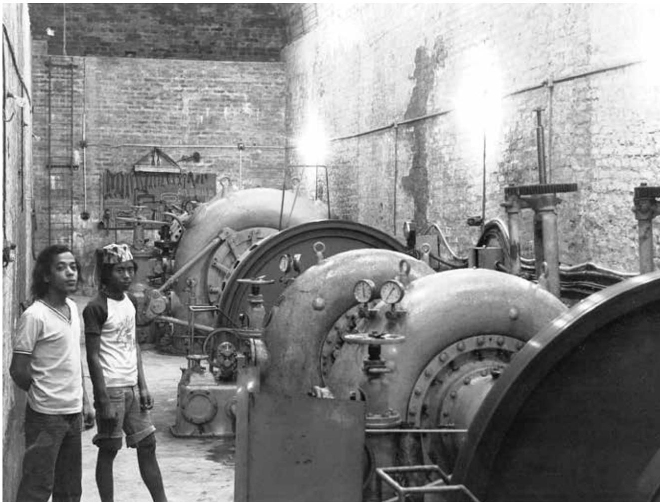
Foto: To lokale kraftutbyggere. Hoftun bak kamera. Bildet er fra Tinau kraftverk. Francisturbinene kommer fra kraftverk på Sørlandet med ca. 50 m fall.
