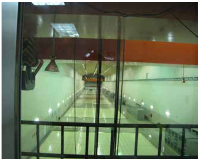
Maskinsalen på Ertan. 280 meter lang, ca. 30 meter bred fra bergvegg til bergvegg og ca. 65 meter høy. 6 aggregater, hvert 550 MW, trenger plass. Foto: AGN - Panos Galanos
