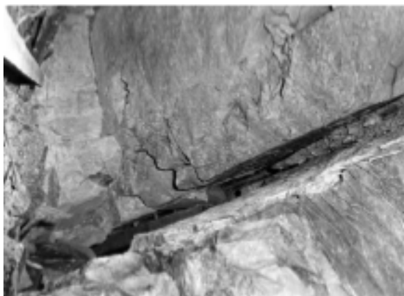
Store slepper og sprekker inne i fjellet.
