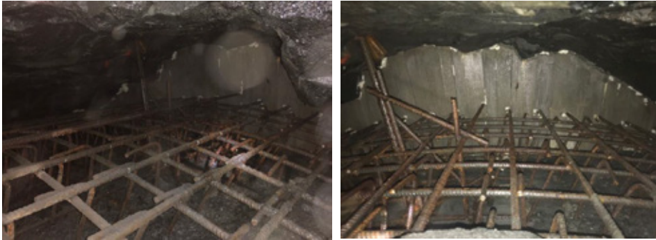
Figur 20: Det manglet betong i en hel støpeseksjon i hengen på Midtgardsormen.
