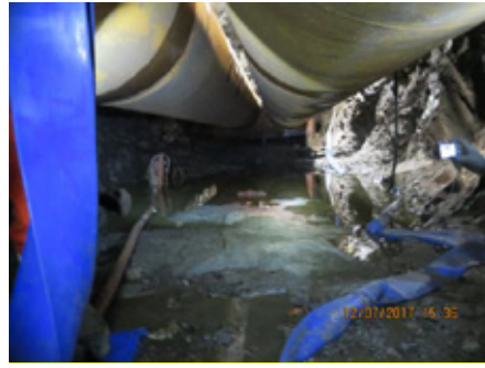
Figur 7: Alnaelven er tørrlagt under rørene.
