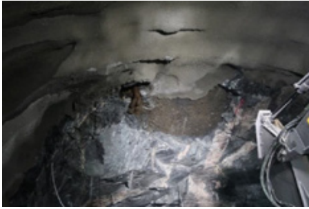
Figur 8: Eksponering av betongplate på elvebunnen.
