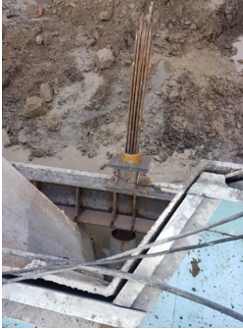
Figur 9: Viser ferdig montert lastcelle på lissestag i øvre stegrad i september 2019. Foto: Cautus Geo
