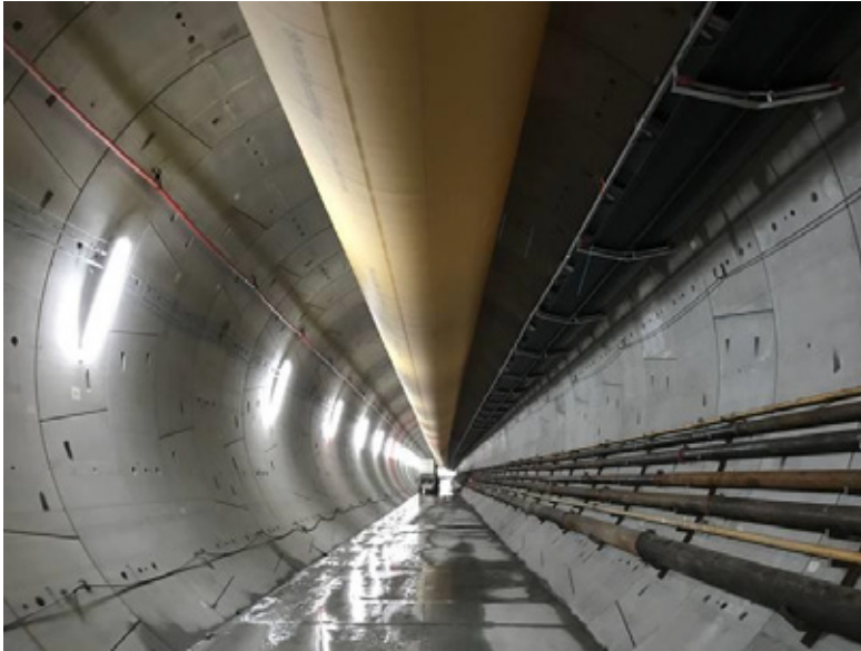
Figur 5 Typisk tunnelverrsnitt for en betonglinet tunnel illustrert ved foto fra Follobanens tunnel.
