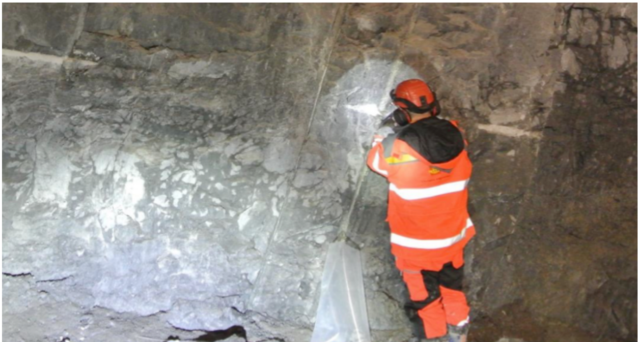
Figur 6 Kartlegging av injeksjonsborhullpiper med hvit injeksjonsmasse i Bjørnegårdtunnelen. (van Oosterhout 2016)
