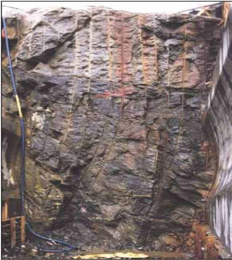
Figur 5.10. Eksempel på uheldig retningsavvik
