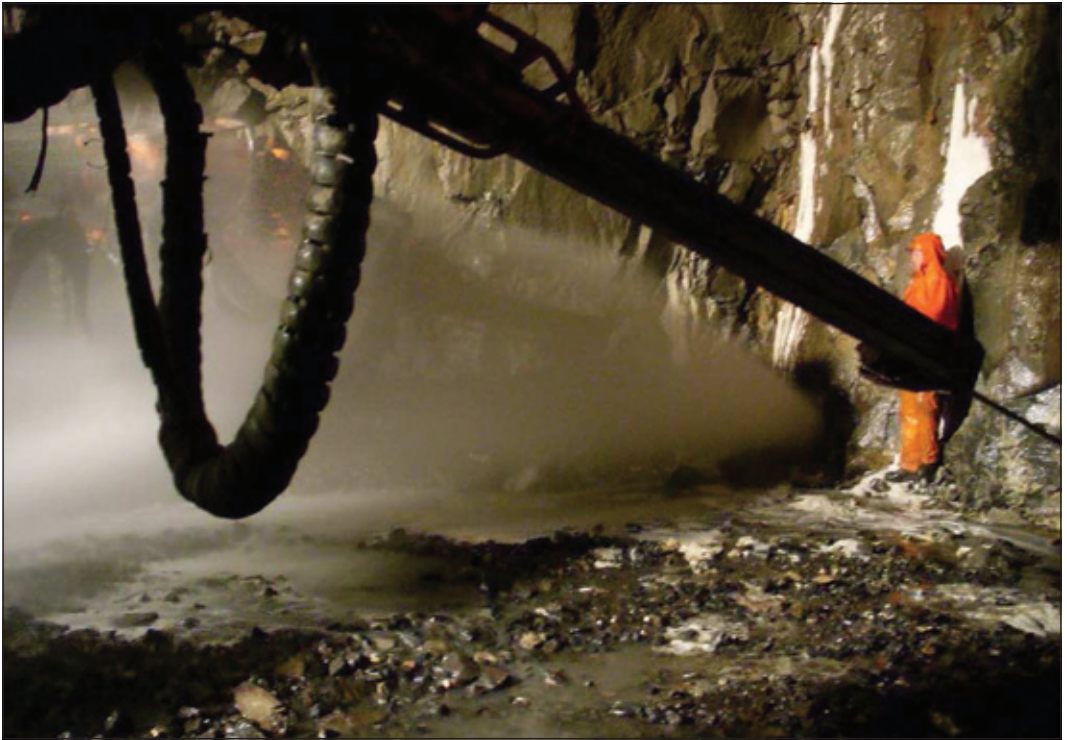
Figur 6 Eksempel på kraftig vanninnbrudd ved tunnelanlegg på Island. Foto Bjørn Hardarson.
