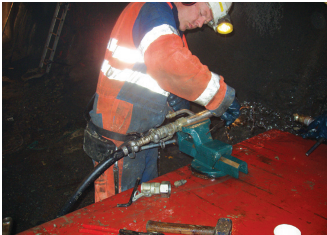
Figur 17 Eksempel på arbeidsbenk på en injeksjonsrigg
