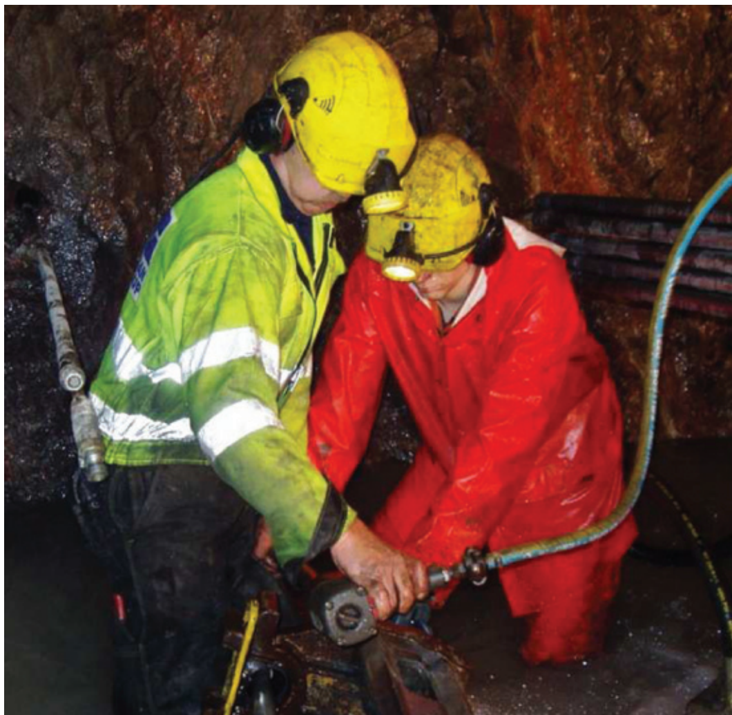
Figur 15 Eksempel på situasjon ved store innlekkasjer.
