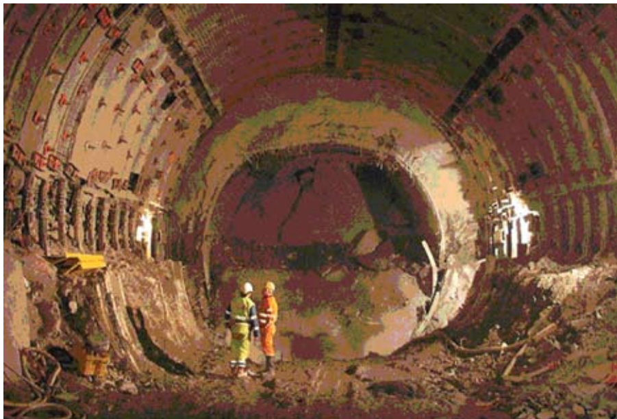
Figur 17. Deformerbart sikringssystem for høye bergspenninger og store deformasjoner. Fra ny St. Gotthard jernbanetunnel, foto Amberg Engineering
