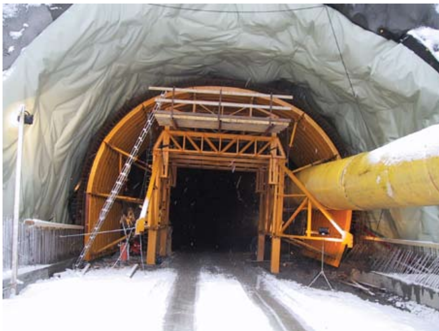
Figur 19. Bildet viser eksempel på Flexiskjold som ble benyttet i adkomsttunnelen til Melkøya
