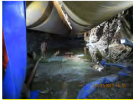
Figur 7: Alnaelven er tørrlagt under rørene.
