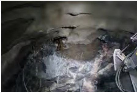
Figur 8: Eksponering av betongplate på elvebunnen.
