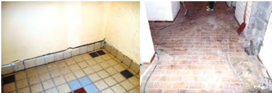
Figur 3. Eksempel på byggningsskader forårsaket av svellende alunskifer (Foto: Løvlien Georåd AS)
