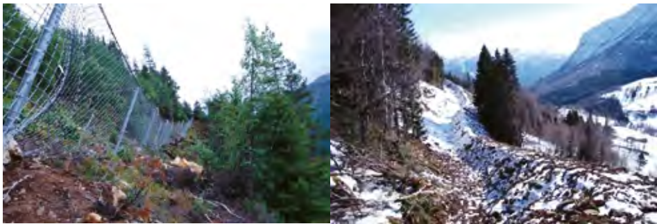
Figur 3. Eksempel på sikringstiltak langs trasseen for å unngå steinsprang mot underliggende områder, jordvoller og steinsprangnett.
