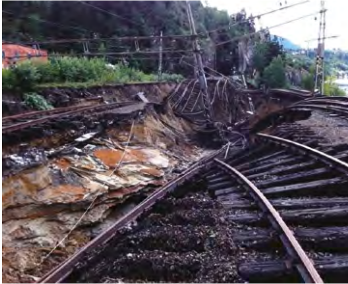
Figur 20. 1: Store skader på Notodden jernbanestasjon etter regnvær 23. juli 2011 (Foto: Kjell Aulie, 24. juli 2013).
