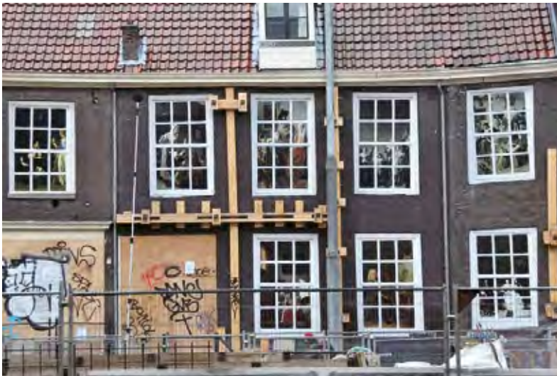
Figur 1. Setningsskade ved Vijzelgracht stasjon, Amsterdam ( www.tunneltak.com ).
