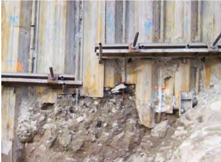
Figur 12. Eksempel på utett overgang mellom spunt og berg (foto Norconsult).
