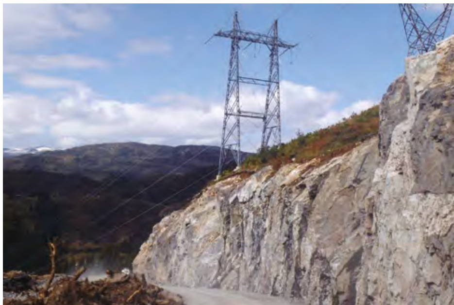
Figur 4. Høyspentmastene og berget med fall mot vegen.
