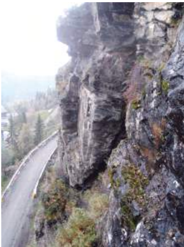
Bilde 1. Berghammer med åpen sprekk bak.
