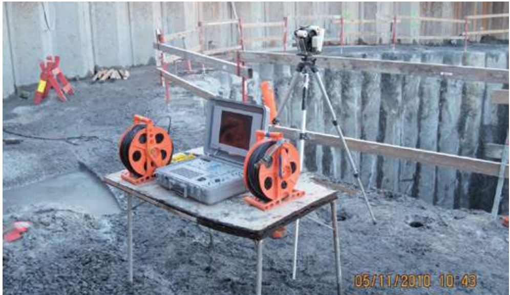
Figur 33 Kontroll av sekantpeler vha. mellomhullsseismikk.
