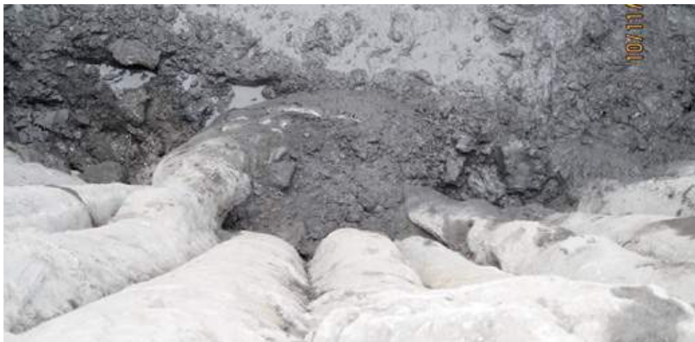
Figur 27 10. november 2010. Ujevne peler. Markerte betongutvekster.
