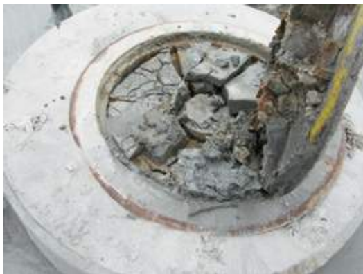
Figur 13 Ikke synlig flytende vann og slik sett tørre masser inne i kum 203 som for øvrig nesten var begravd av utlekkede masser.
