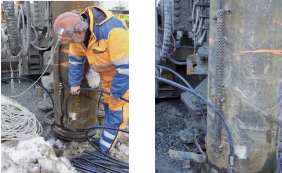
Figur 8: Totaltrykkcelle montert på spuntrør. Rør for injeksjon mellom rør og berg er påmontert. Til høyre modifisert montering med beskyttelse.
