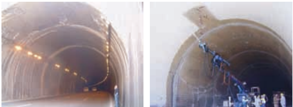
Figur 13. Chekka tunnel, Libanon. Til venstre: tunnelens tilstand før rehabilitering med lekkasjer gjennom dilatasjonsfugene og sprekker i betonghvelvet. Til høyre: nye dilatasjonsfuger er etablert, sprekker er injisert med polyuretan med høy mekanisk fasthet, og Masterseal®345 sprøytes direkte på den gamle betongen med mekanisert sprøyting.
