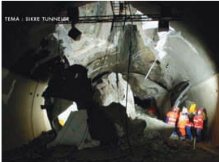
Figur 1. Bilde fra raset i Hanekleivtunnelen. Legg merke til den store blokken midt i bildet. (GEO januar 2007)
