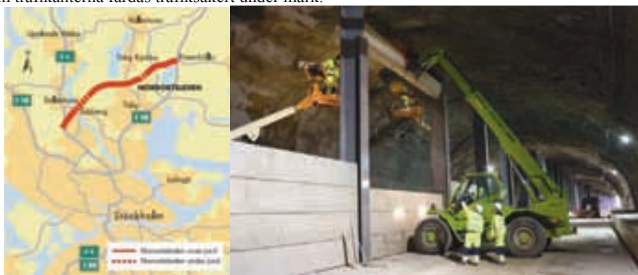
Figur 6. Norrortsledens sträckning med Löttingetunneln i den högra delen av bilden. Figur 7. Installation av trafikskiljande och explosionssäker mittvägg i Löttingetunneln.
