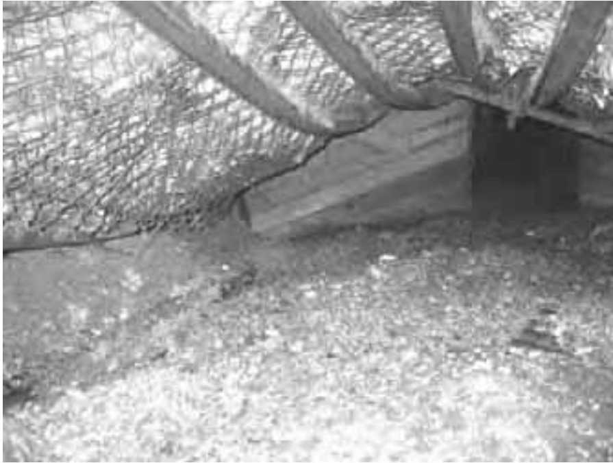
Figur 18.3 Før rehab, omr A3 – rasmasser på hvelv og i nett som henger på stålprofiler
