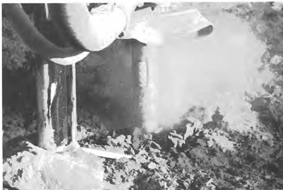
Fig. 4-2. Stabilisator mellom borkrone og første stang.
