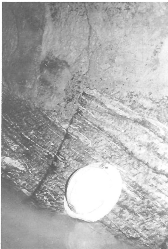
Fig. 5–6. Mørke klorittstikk er bruddanvisere.
