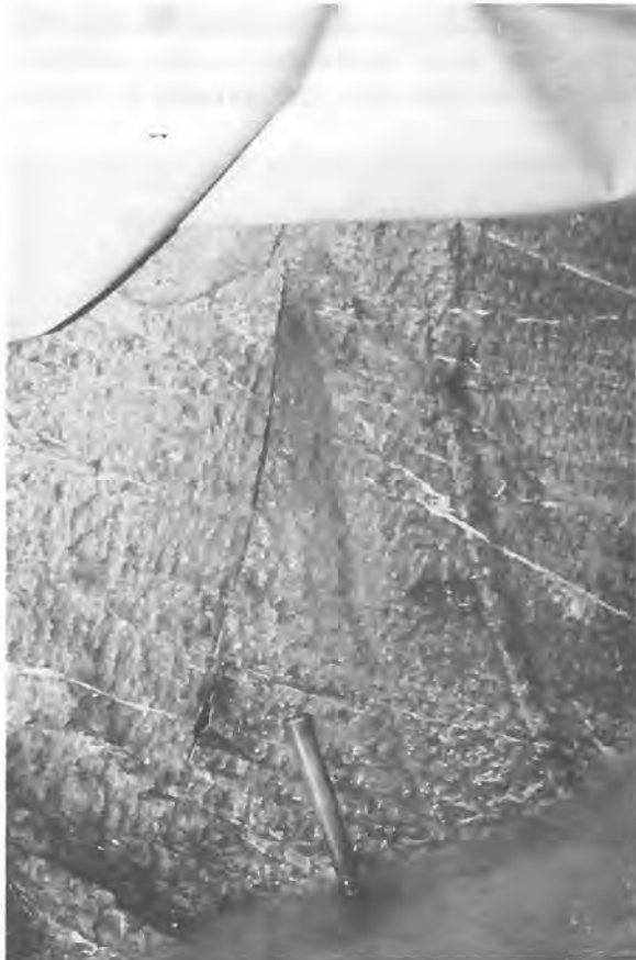
Fig. 5—8. Liten lokal lekkasje.
