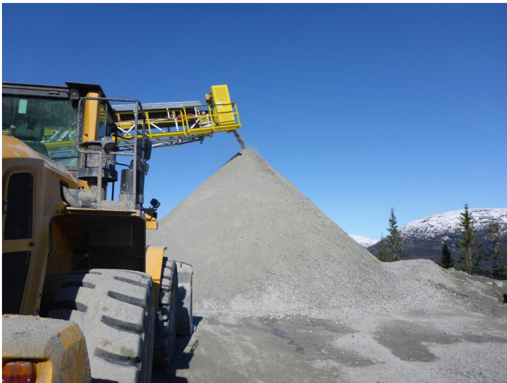
Røssåga kraftverk, mai 2014
