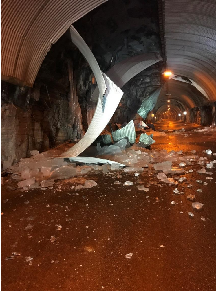
Fv 866 Kågentunnelen, Skjervøy kommune, Troms, 1.737 meter, åpnet i 1991. Isskjøving
